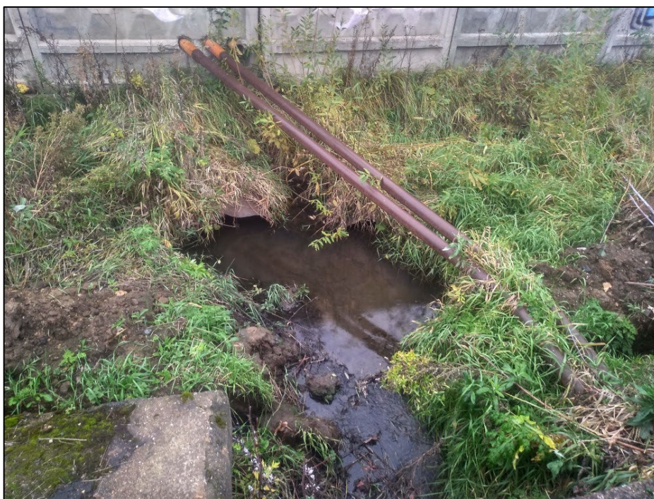
Рисунок 6.4 – Коллектор р. Лобня на выходе (с северной стороны от ветки ж/д)
